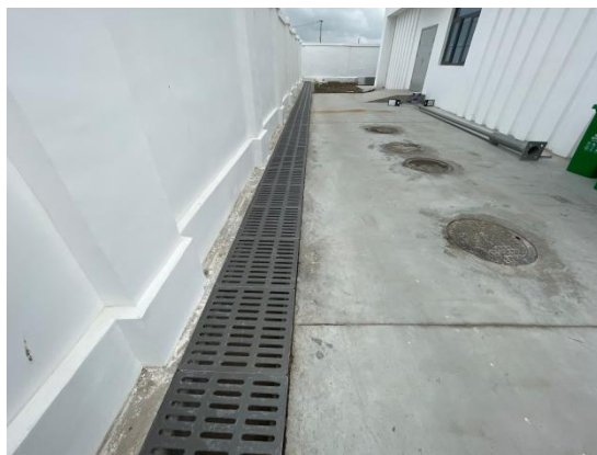
通海港站化粪池、隔油池
