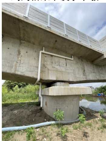
桥面径流收集
